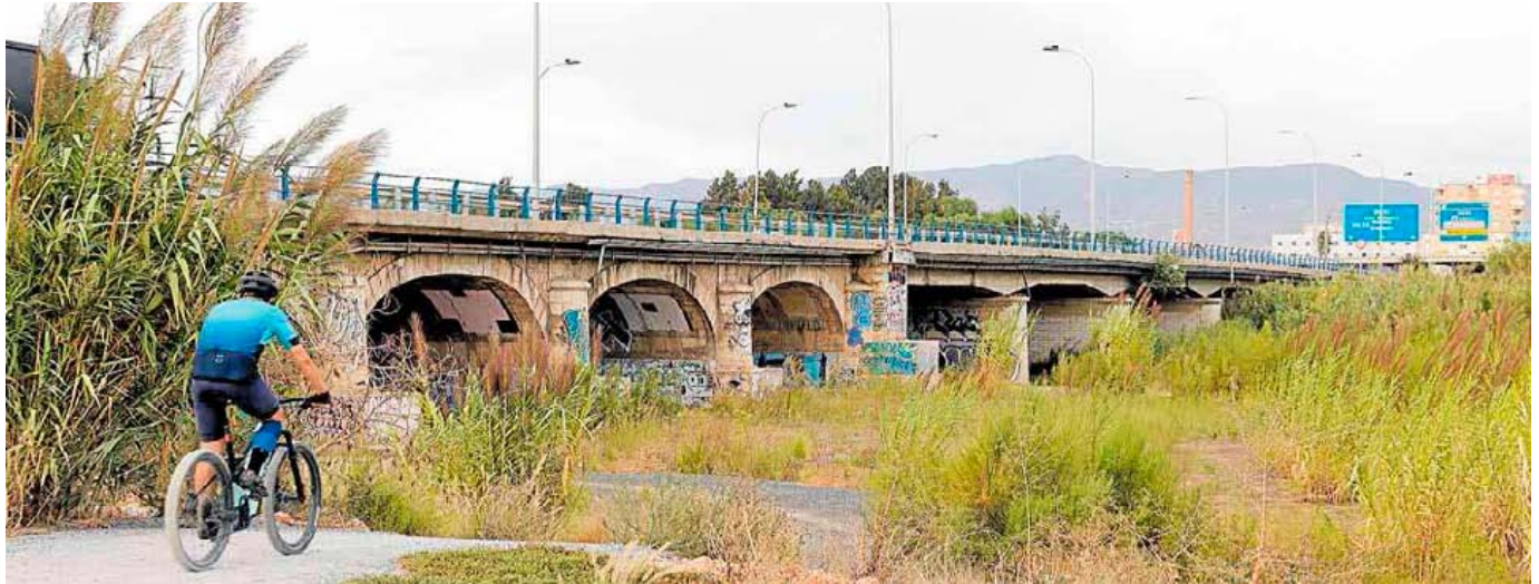
Vista tomada esta misma semana en el puente de la MA-21 cuyos vanos serán ampliados para ganar en seguridad. MIGUE FERNÁNDEZ
