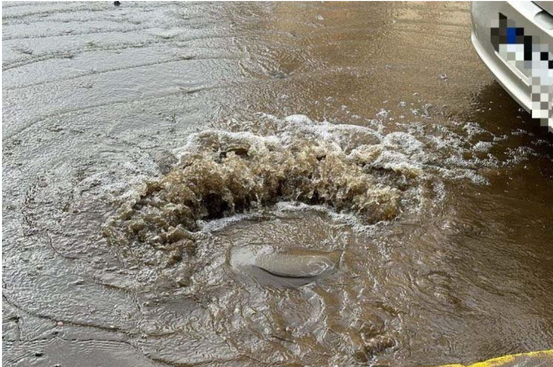
Una de las calles afectadas por una avería en La Línea, prácticamente inundada.
